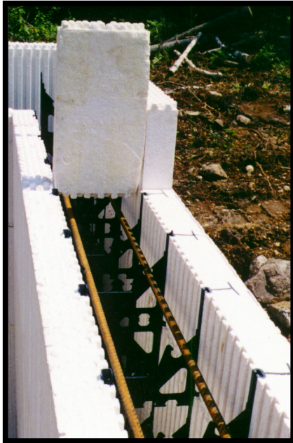
Fig 11.2 Installation de l'acier d'armature dans le seuil d'une ouverture au moment de la construction du mur.
