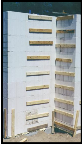
Fig. 6.3 Joint vertical renforcé par des lanières de bois de 2,5 cm x 7,6 cm
